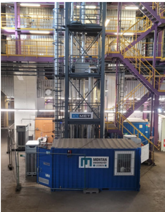
Abb 1: Blick auf Methanisierungscontainer und Aminwäscher in der Kraftwerkshalle bei der voestalpine Stahl GmbH in Linz
