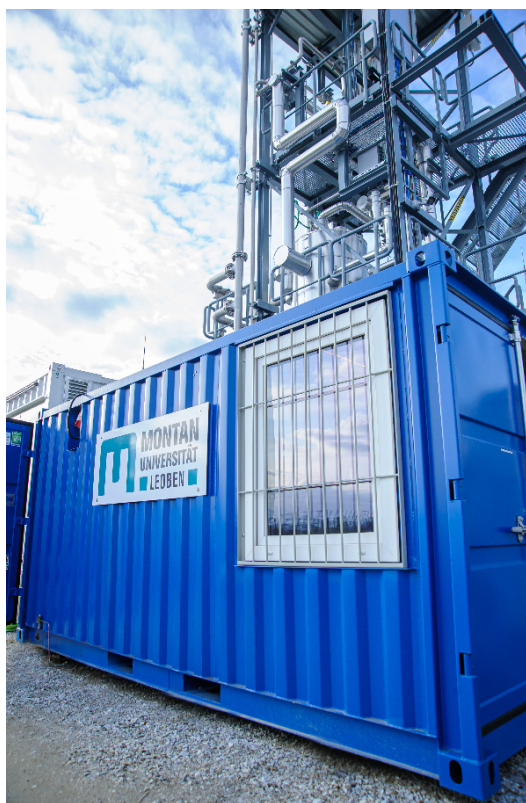
Abbildung 1: Einsatz der Montanuni-Methanisierungstechnologie am Standort der Biogasanlage Gabersdorf im Projekt „Renewable Gasfield“
